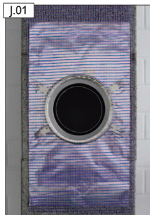
Ansicht Feuerstättenanschluss mit eingebautem Schiedel Edelstahl-Anschlussfutter:
