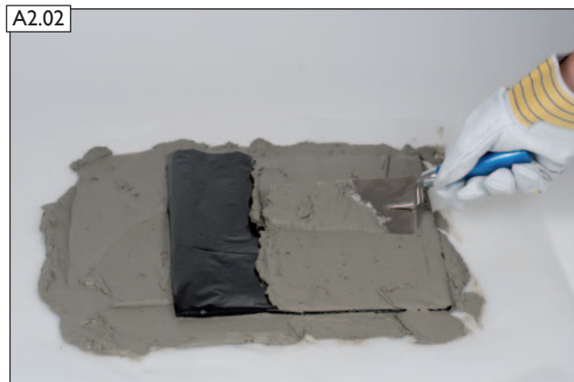
A2.02 Mörtelbett vorbereiten, Feuchtesperre einlegen, Mörtel MG(M5) Ila (Mauermörtel nach EN 998-2) auftragen.
