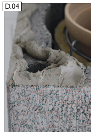
ACHTUNG! Auf geschlossenen Stegbereich achten!
