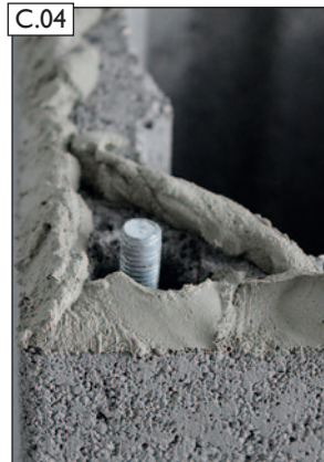
ACHTUNG! Auf geschlossenen Stegbereich achten!
