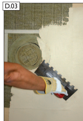
D.03 Påfør pudslaget på på hele overfladen. OBS! Indvendige rørskåle må ikke dækkes med gipsplader eller pudslag
