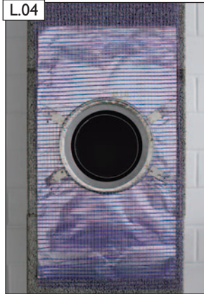
Ansicht Feuerstättenanschluss mit eingebautem Schiedel Edelstahl-Anschlussfutter.
