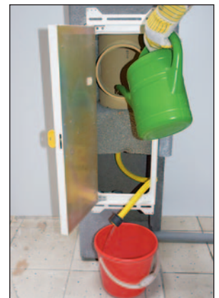
Kondensatteller und Siphonschlauch spülen.
