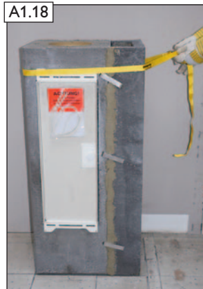
Spanngurte lösen. HINWEIS! Die Spanngurte werden im weiteren Versetzvorgang nicht mehr benötigt!
