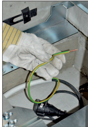
Bauseitiger Potentialausgleichsleiter „herausangeln“ und zur Potentialausgleichsanschlussklemme führen.
