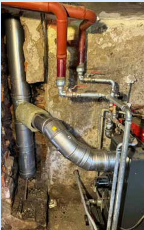
Ukážka zásadného zásahu do komína pri jeho vložkovaní. Komín sa upravil pre použitie nového spotrebiča na drevo. Všimnite si vhodné umiestnenie čistiaceho a revízneho otvoru v dymovode.
