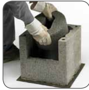
1.3 ...és helyezük el a vízszigetelést, amire habarcs ágyzatba kerül az első köpenytégla. Állítsuk vízszintbe, majd tegyük bele a beton indítólapot.
